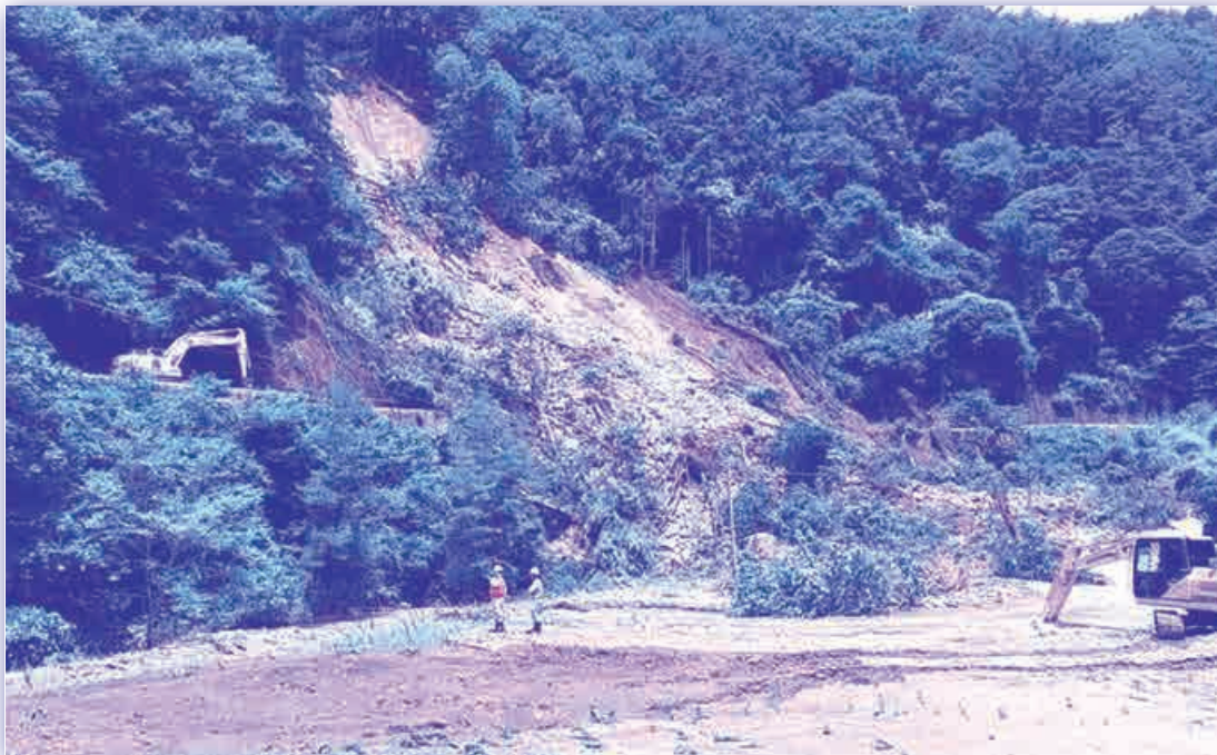
令和2年7月12日 県道大島線土砂崩落現場
